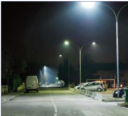
Via Enego con il vecchio e nuovo sistema di illuminazione
